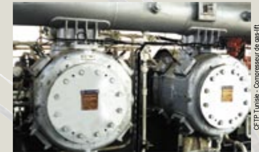
CFIP Tunisie - Compresseur de gas-lift
